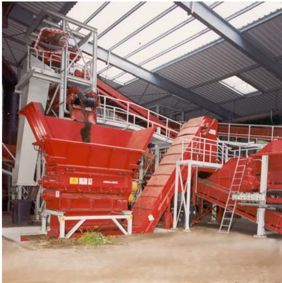
Aufbereitung durch Auflockerung, Störstofffassung, Klassierung, Zerkleinerung und Homogenisierung
