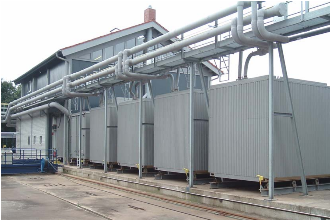
Druckbelüftete, wärmisolierte Rottecontainer
