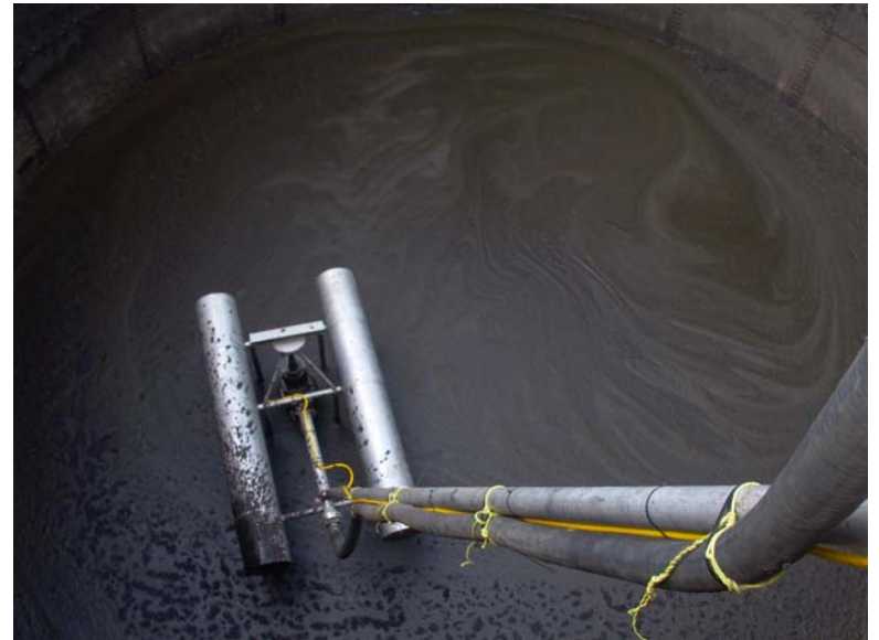
Flüssiges Gärprodukt, offener Tank
