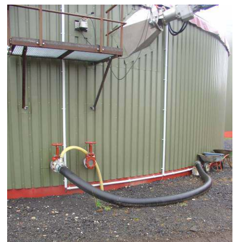
Rührwerk mit außen liegendem Antrieb und Entnahmestelle
