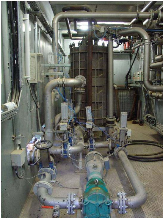
Wärmetauscher mit Rohrführung und Pumpe
