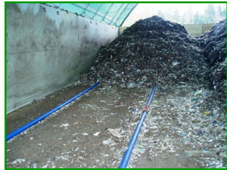
Belüftungsrohre in Halle
