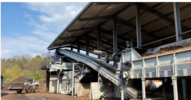
Abb. 4: 4-Fractionen-Schwingsiebzanlage mit FE-Metallabscheidung, Windsichtung und Steinfalle zur gezielten Fremdstoffentfrachtung
