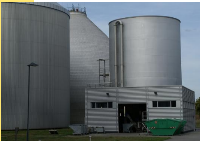
Abbildung 1: MAP-Reaktor auf der Kläranlage Wassmansdorf
